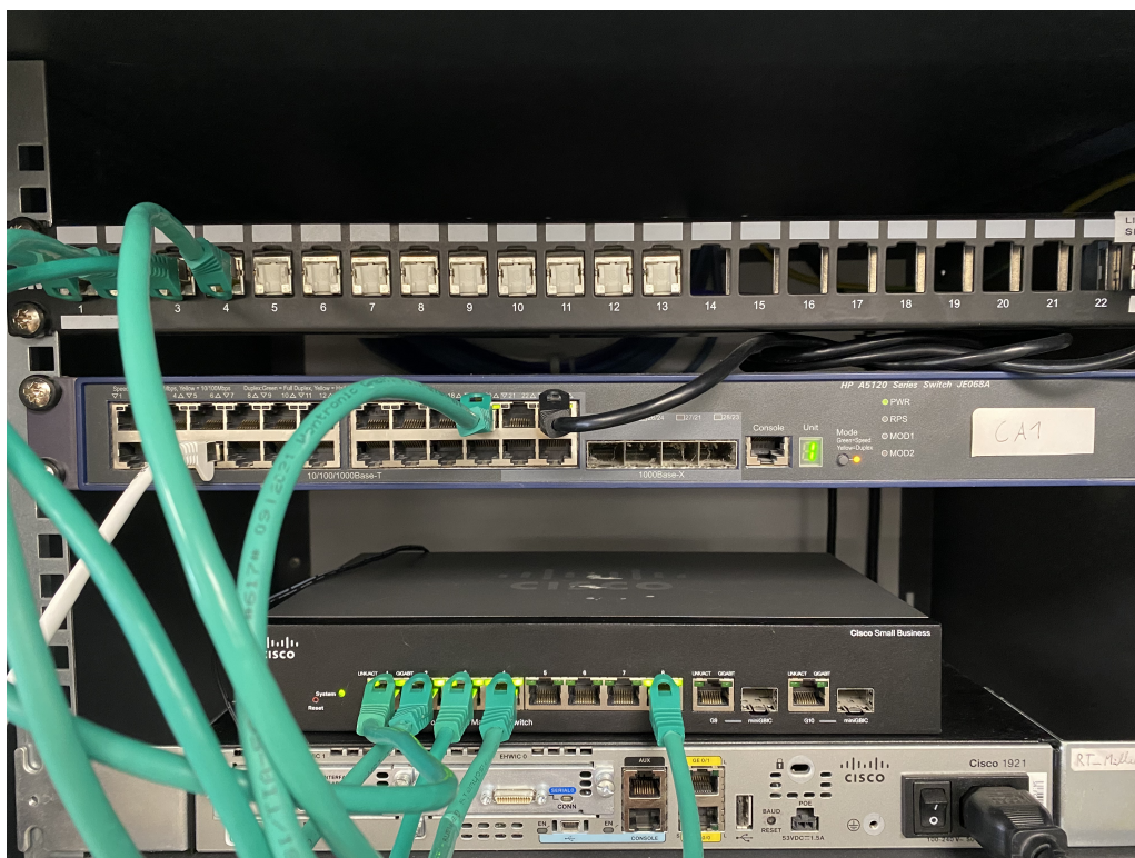
Switch Cisco SG 300-10 utilisé pour le déploiement multicast — port 8 relié au serveur FOG, ports 1–4 aux postes de la rangée
