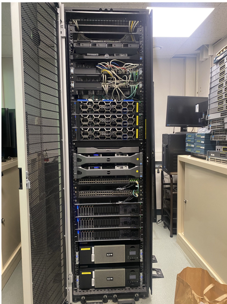
Armoire rack principale — cœur de réseau, cluster Proxmox, cluster Nutanix, NAS, onduleurs Eaton
